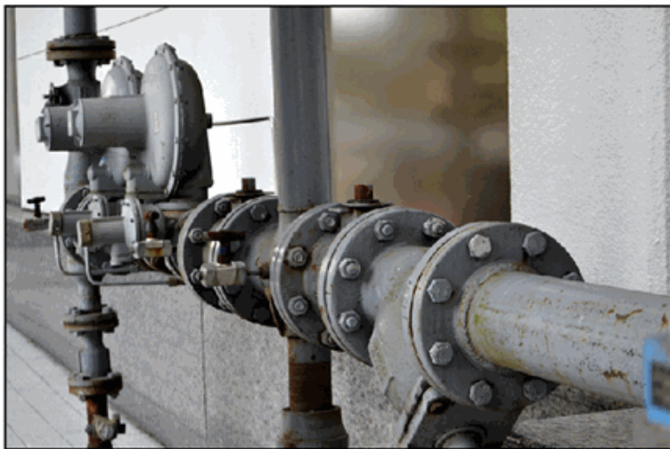
تصویر (۸-۹). بسیاری از سامانه های آب شهری قدیمی و ناکارآمد هستند، خوب نگهداری نشده اند و چگه می کنند.
